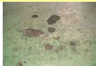
製造工場 補修箇所に油が染み込んでいる場合
